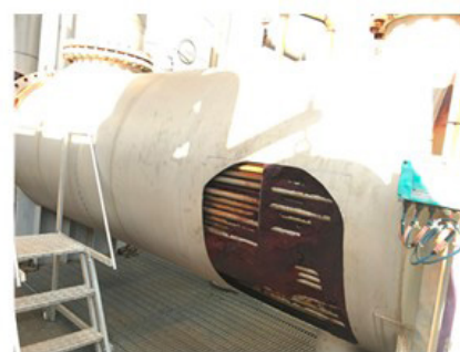
Figura 10 – Incrustação em condensadores da destilaria.
